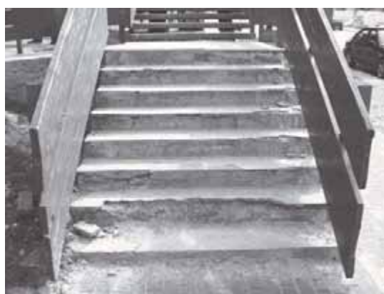
B. Schody z licznymi ubytkami korozyjnymi.
