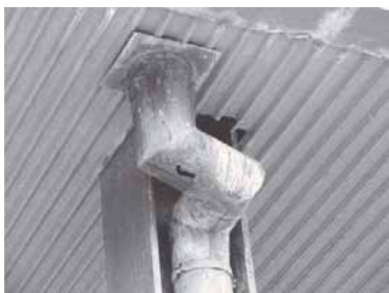
A. Silnie uszkodzone przez korozję rury spustowe.
