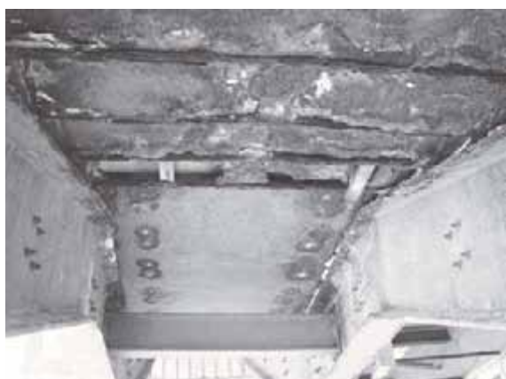
C. Skorodowane, z licznymi ubytkami trepy schodów.
