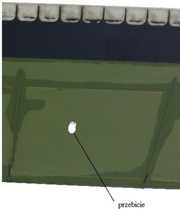
Rys.3 Uszkodzenie (przebicie) sekcji łopaty nr WK 5084953
