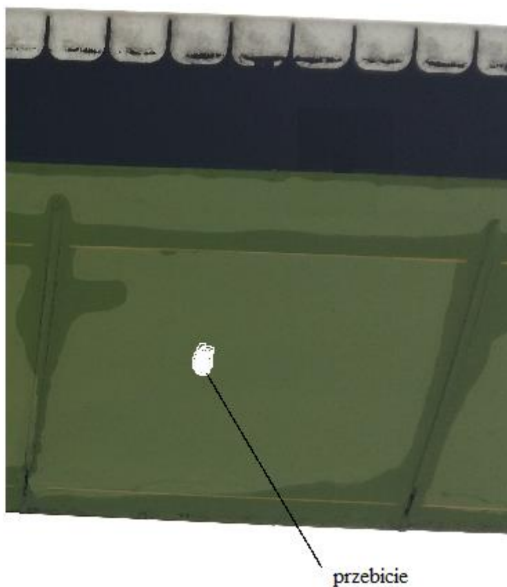
Rys.3 Uszkodzenie (przebicie) sekcji łopaty nr WK 5084953
